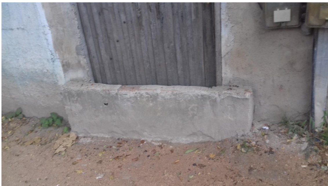
FIGURA 56 - MURETA CONSTRUÍDA POR MORADOR LOCAL PARA EVITAR A ENTRADA DE ÁGUA DAS CHUVAS QUANDO DA OCORRÊNCIA DE ALAGAMENTOS
