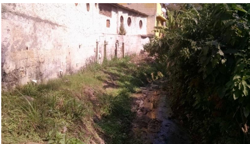
Imagem 2. Esgoto oriundo de lojas comerciais adjacentes à calha
